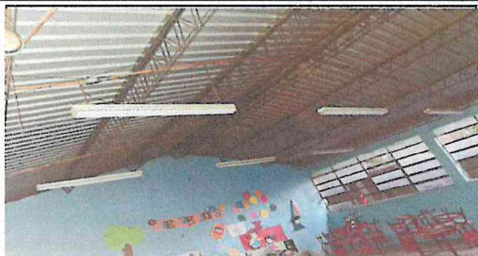
Foto1: Sustitución de lámparas interiores
